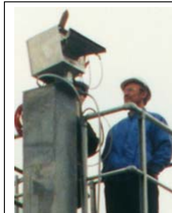
Сканер в защитном кожухе, установленный на башне
